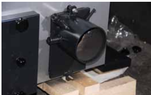
Rökgasfläktens adapter monterad i pannans utloppsöppning.
