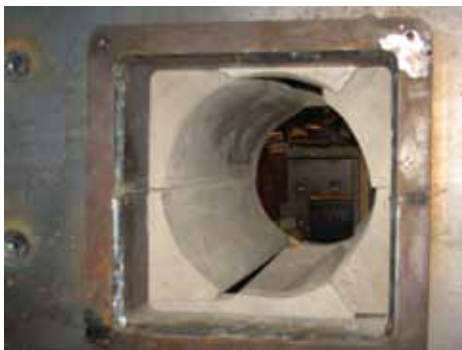
7. Övre delarna för sidoteglen 2 st. (obs häntheten). Den tillfälliga stödet avlägsnas, installationen är klar.
