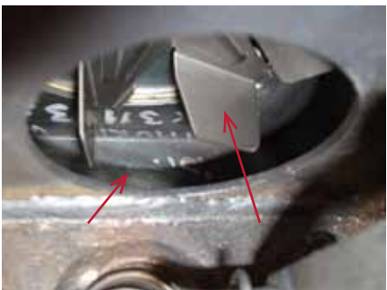
7. Puhdista savukaasupuhaltimen siivet ja poista tuhka puhaltimen laatikosta esim. tuhkaimurilla.
