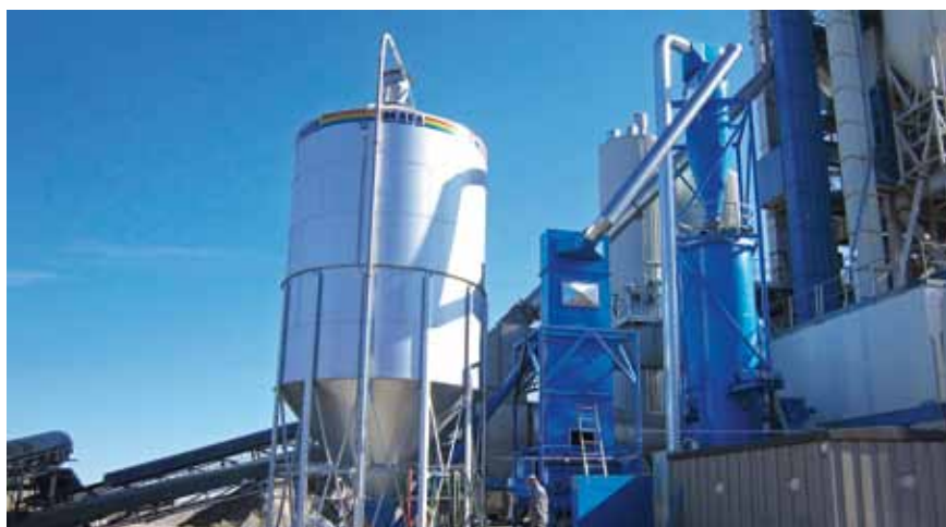
En pelletssilo installerades vid asfaltverket i Kjula utanför Eskilstuna i juni 2012.
